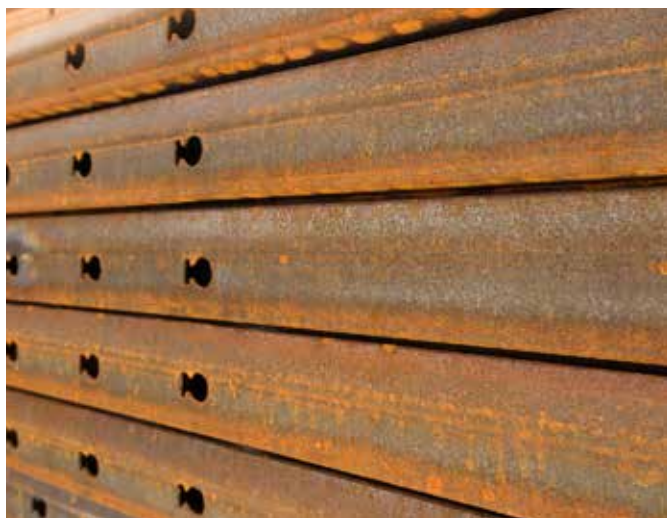
Pali di testata 60x70 - ossidazione in fase intermedia
